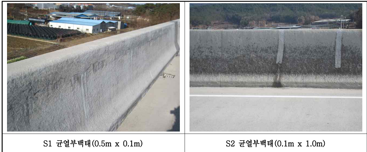
【사진 7.3.24】 방호벽 및 중앙분리대 손상현황
