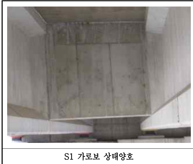
S1 가로보 상태양호 【사진 7.3.7】 가로보 손상현황
