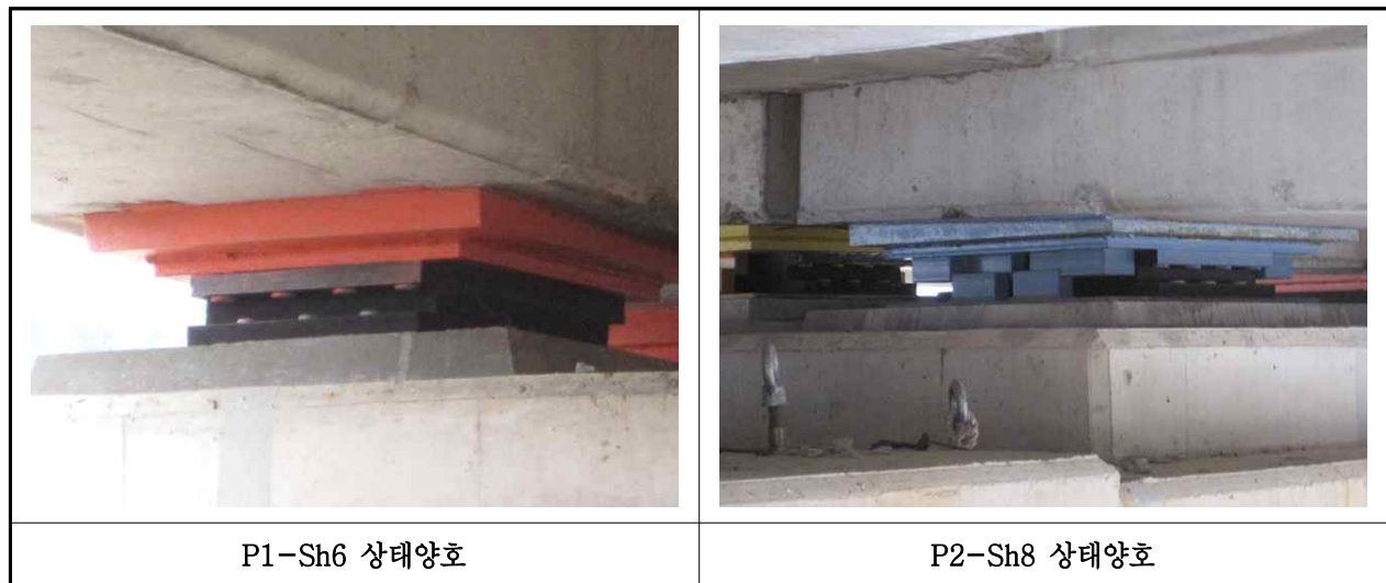
【사진 7.3.13】 교량받침 손상현황
