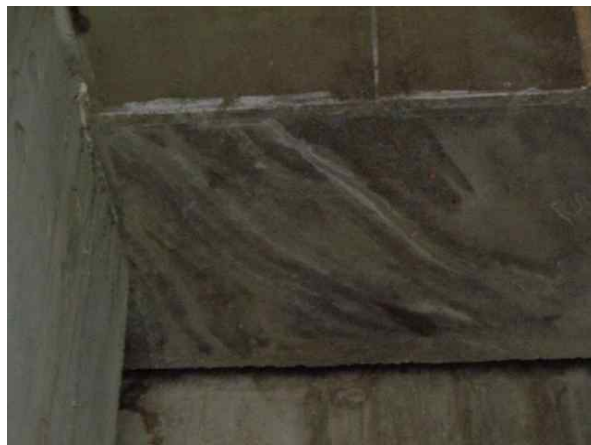
S1 바닥판하면 백태(0.5m x 0.5m)
